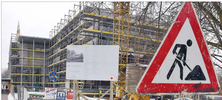
Ist der neue Museumsbau fertig, soll er durch ein in Lüneburg einmaliges System temperiert werden.
